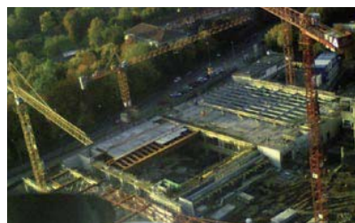
GS Rodenkirchen (Architekt: KSP Engel und Zimmermann, Köln; Bauherr: Hochtief PPP GmbH & Co. KG, Essen)
