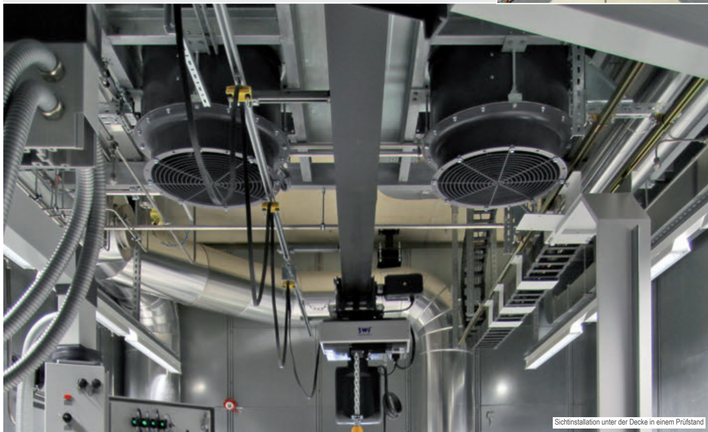
Technikfläche zwischen den Prüfständen
