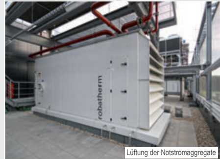
Technik auf dem Dach
