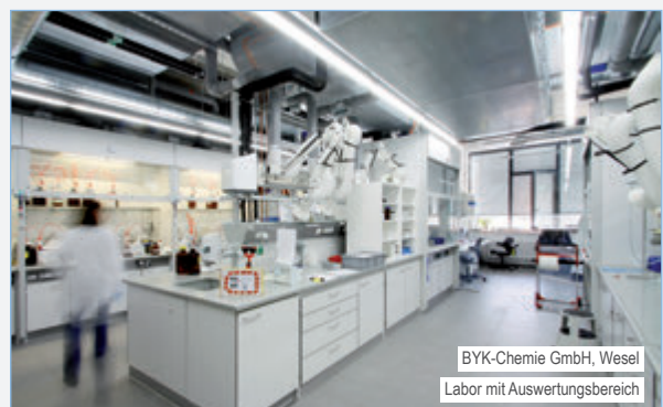
BYK-Chemie GmbH, Wesel Nutzung der vollen Raumhöhe durch Installationen unter der Decke
