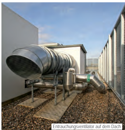
Entrauchungsventilator auf dem Dach
