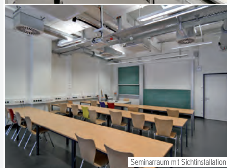
Seminarraum mit Sichtinstallation
