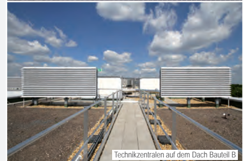
Technikzentralen auf dem Dach Bauteil B
