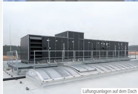
Lüftungsanlagen auf dem Dach
