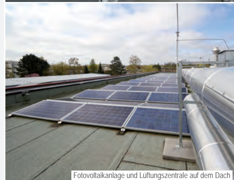
Fotovoltaikanlage und Lüftungszentrale auf dem Dach
