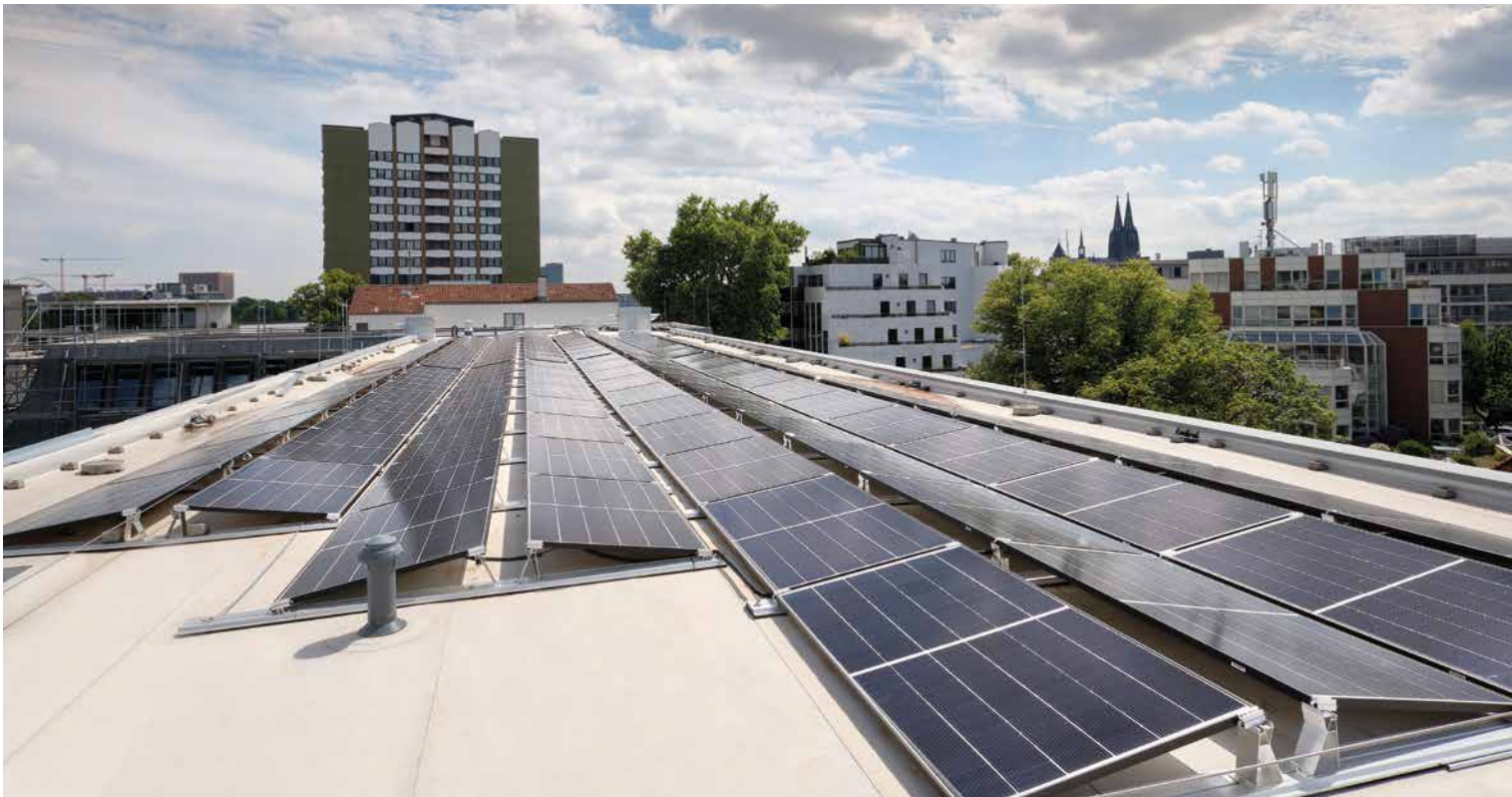
Die neue Photovoltaikanlage auf dem Dach ist auf die maximal mögliche Spitzenleistung des gesamten Gebäudes ausgelegt und kann so den Spitzenbedarf in den Sommermonaten zu fast 100% decken.
