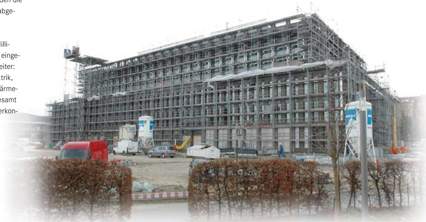
Noch ist die Stadthalle eingerüstet, aber das prägende Erscheinungsbild der hochwertigen Fassade aus pulverbeschichteten Aluminium lässt sich bereits jetzt schon erahnen.
